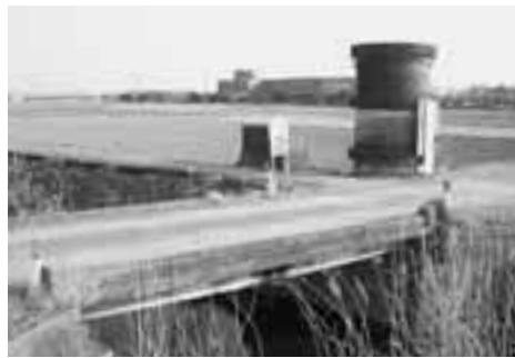
老朽化した玄蕃橋
