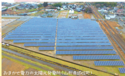
おまかせ電力の太陽光発電所(山形県遊佐町)
