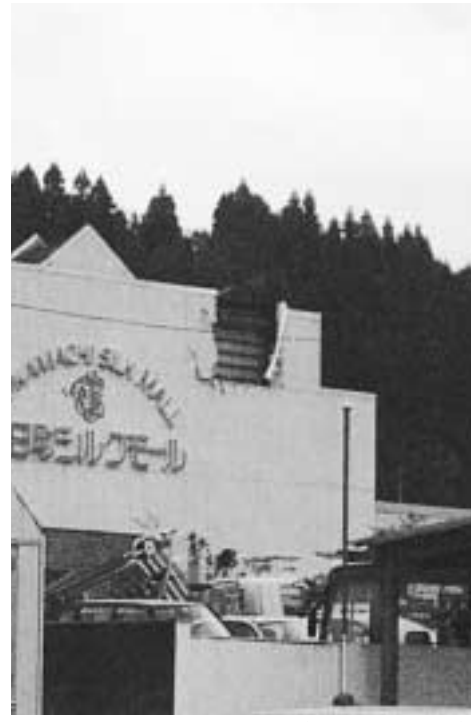
▲地震により壁がおちた建物（新潟県十日町市）
