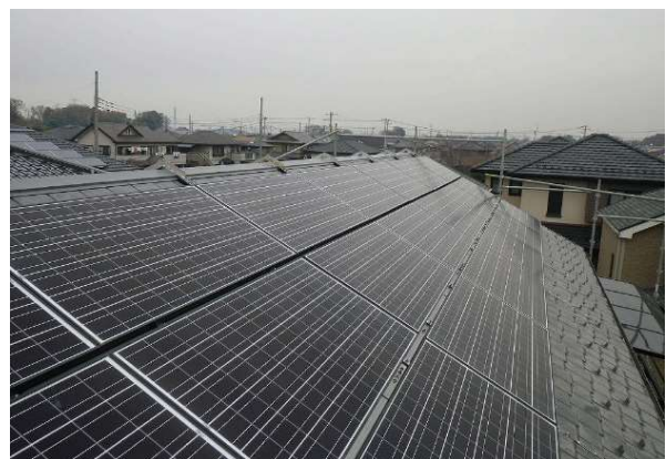
太陽光発電システム
