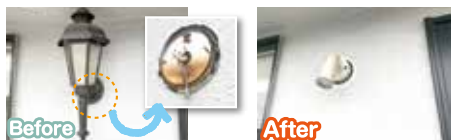
Before: ポーチ灯の根元の茶色く変色しているところまで水が溜まり漏電を引き起こしていました。 After: ポーチの照明器具を交換。これで漏電の心配もなくなりました。
