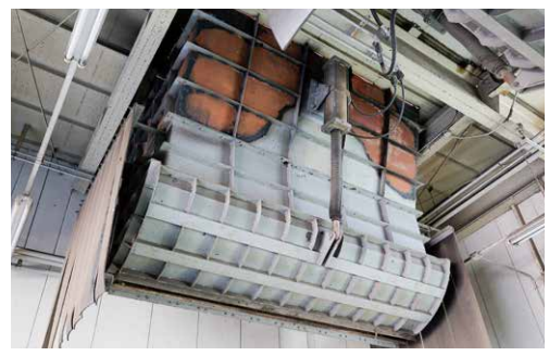
▲実際に内部が炎上したクリーンセンターの機械。側面には赤茶色の焼け跡が残っています。
