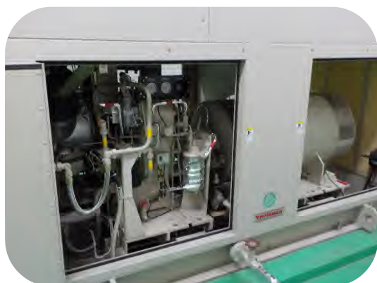
自家発電設備
