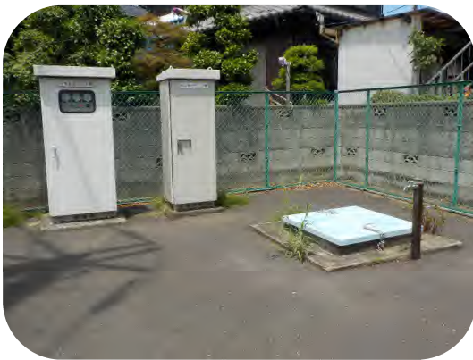
取水井外観(第4号)
